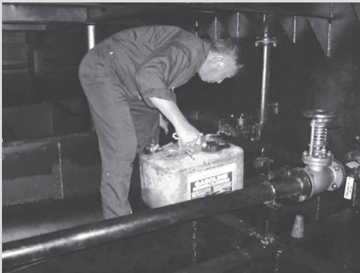
ห้องเก็บน้ำมันสำรอง ร.ล.หัวหิน
